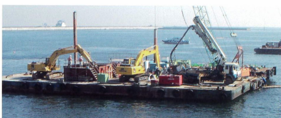
⑩ 海上に設置された仮設プラント
